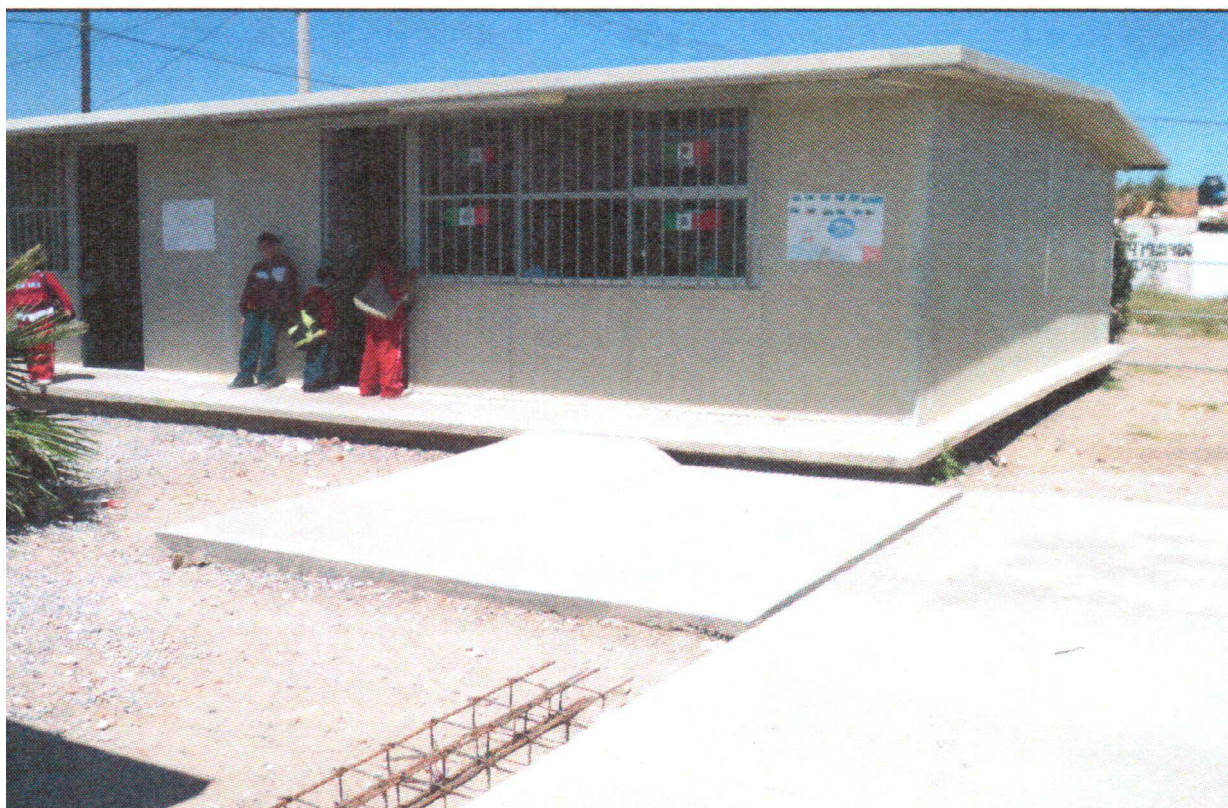
ESCUELA PRIMARIA DOLORES REYES VELAZQUEZ FRACCIONAMIENTO REAL DE PEÑASCO SAN LUIS POTOSI, S.L.P.
